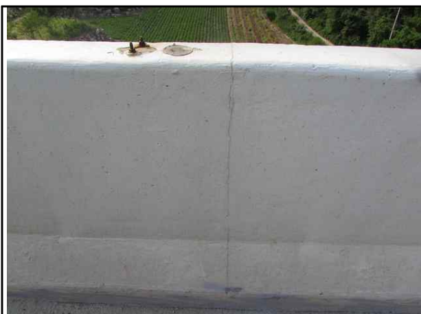
방호벽 S2 균열(0.3mm미만)
