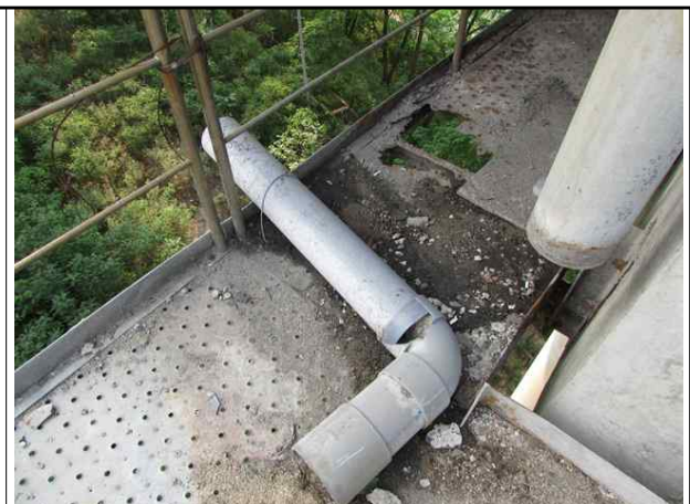
교각 P2 점검시설 부식(추락위험)
