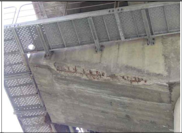
교각 P2 코핑 박락 및 철근노출
