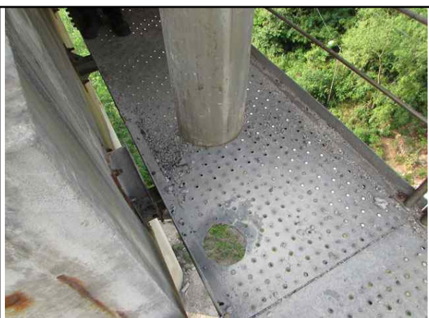
배수시설 P2 배수관 길이부족
