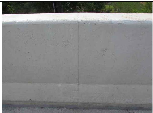
방호벽 S1 균열(0.3mm미만)
