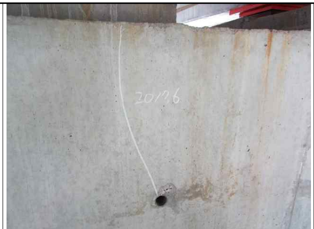
교각 P2 코핑 균열(0.3mm미만)
